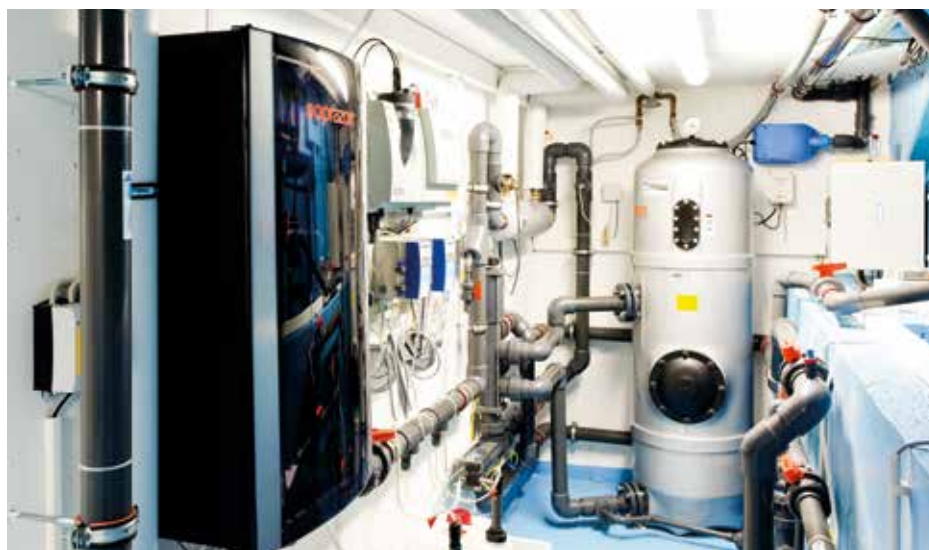
Kleiner Technikraum, in dem trotzdem alles gut zugänglich untergebracht wurde. Realisiert von Schwimmbad-Henne.
