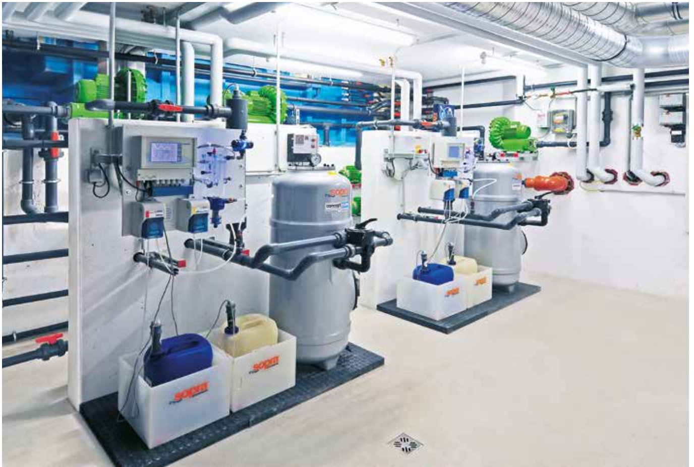
Diese Schwimmhalle ist komplett unterkellert. Entsprechend viel Platz war für die Pooltechnik. Realisiert von sopra Salzburg.
