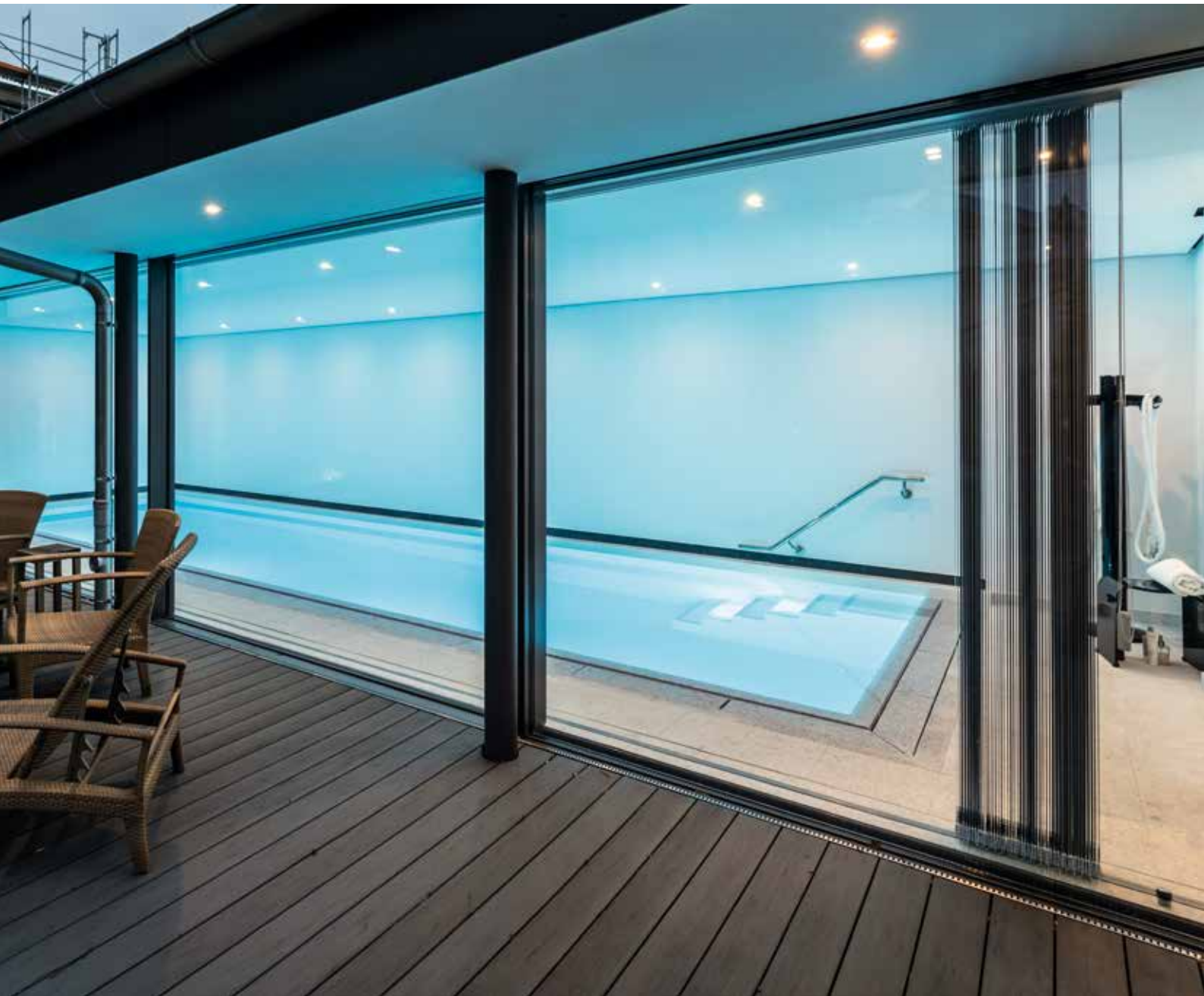
Um Platz zu sparen, wurde das Becken auf zwei Seiten unmittelbar an die Wand geschoben. Auf den zwei anderen Seiten ist es von einer Überlaufrinne eingefasst.
