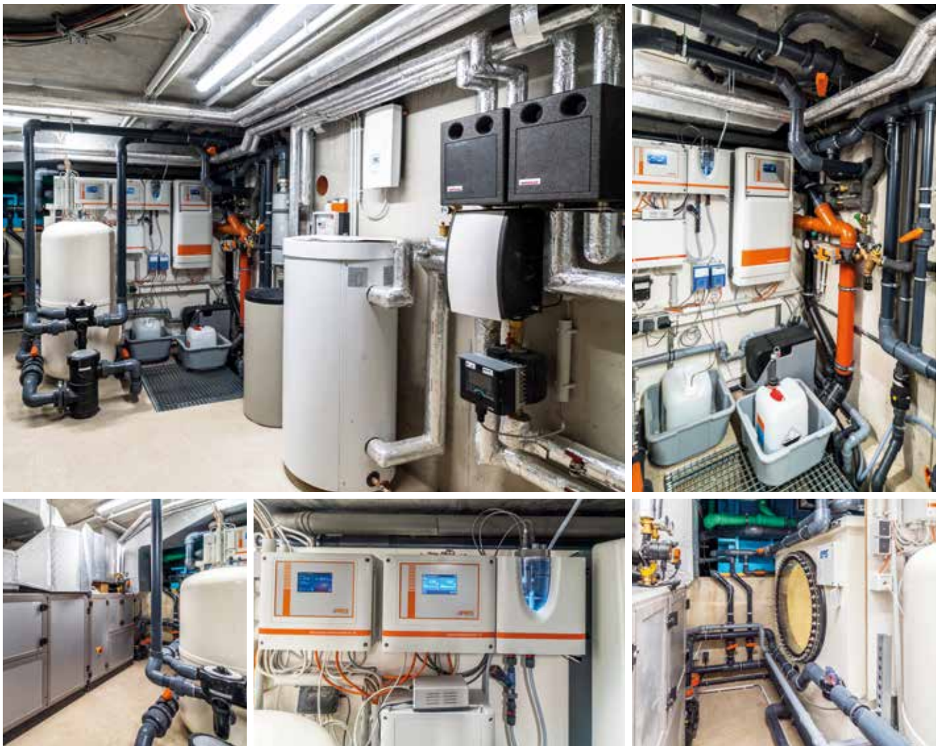
De sopra-zwembadtechniek, de zelfreinigende overloopwatertank en de ventilatie-eenheid van Herget staan in de kelder onder het binnenzwembad.
