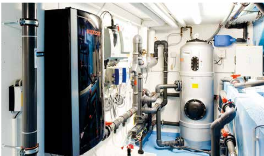
Kleine technische ruimte waar alles toch gemakkelijk bereikbaar is. Gerealiseerd door Schwimmbad-Henne.
