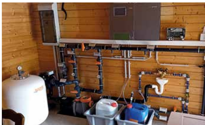
De techniek in het tuinhuis. Het zwembad wordt verwarmd door een warmtepomp.
