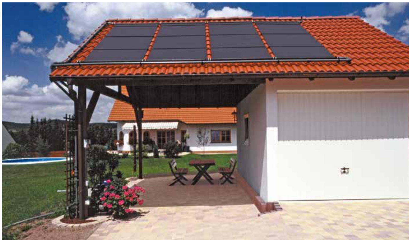
Een zonne-absorber op het dak van een garage voor een energiezuinige verwarming van het zwembad.
