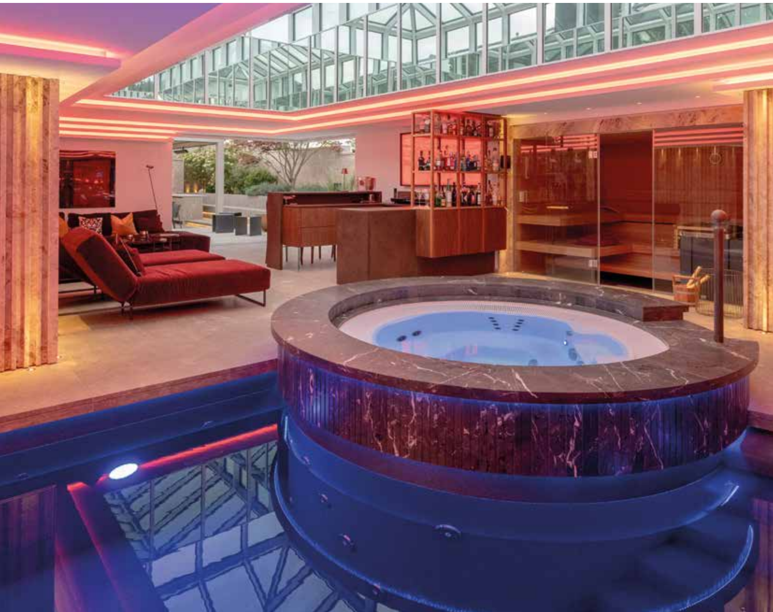
De whirlpool wordt gedragen door een stalen frame en rust op de rand van het bassin. Hij is precies op de grens tussen de oude zwembadhal en de nieuwe uitbreiding geplaatst.
