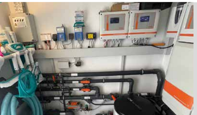
In het nieuw gebouwde tuinhuis is de sopra-zwembadtechniek goed toegankelijk ondergebracht.
